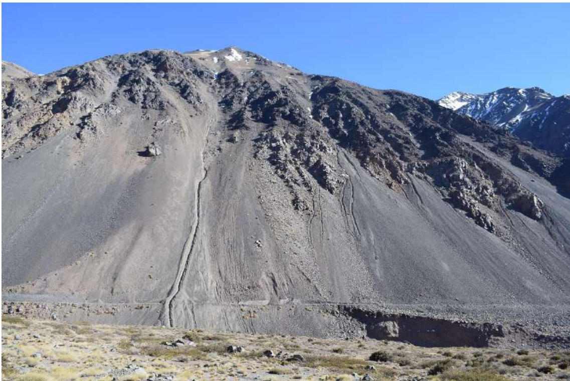
Figura 253. Procesos de remoción en masa sobre tramo de la Vía Turística.
