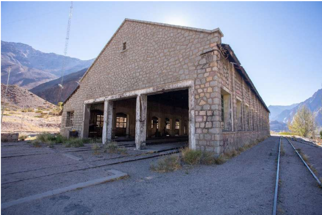
Figura 84. Taller de reparaciones. Estación Polvaredas.
